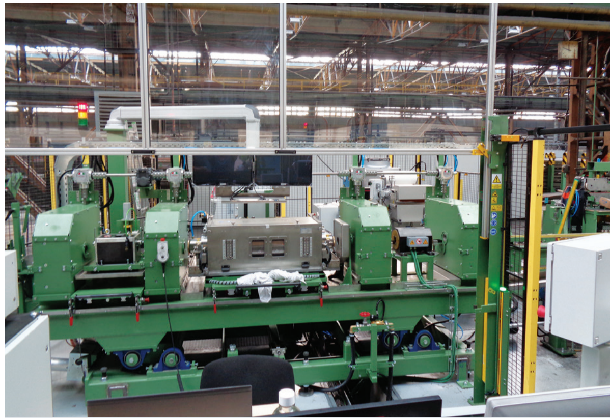
Obnovená úpravárenská linka č. 5 krátko pred spustením.
